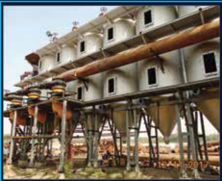
▲ Dry GCP for Mini Blast furnace Project
